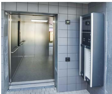
Bei diesem Projekt bietet ein Fahrradfahrstuhl eine komfortable und barrierefreie Zugangsmöglichkeit zur Fahrradgarage im Keller
